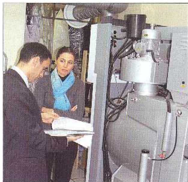
La présence de ventilation mécanique est l’un des points clés de ce contrôle.
